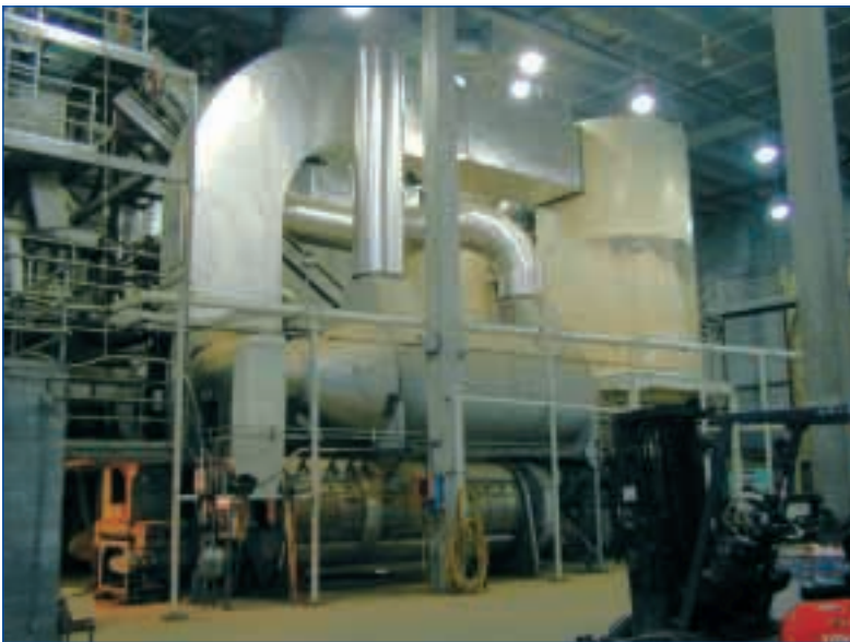
Große Trocknungsanlage für Schlämme
