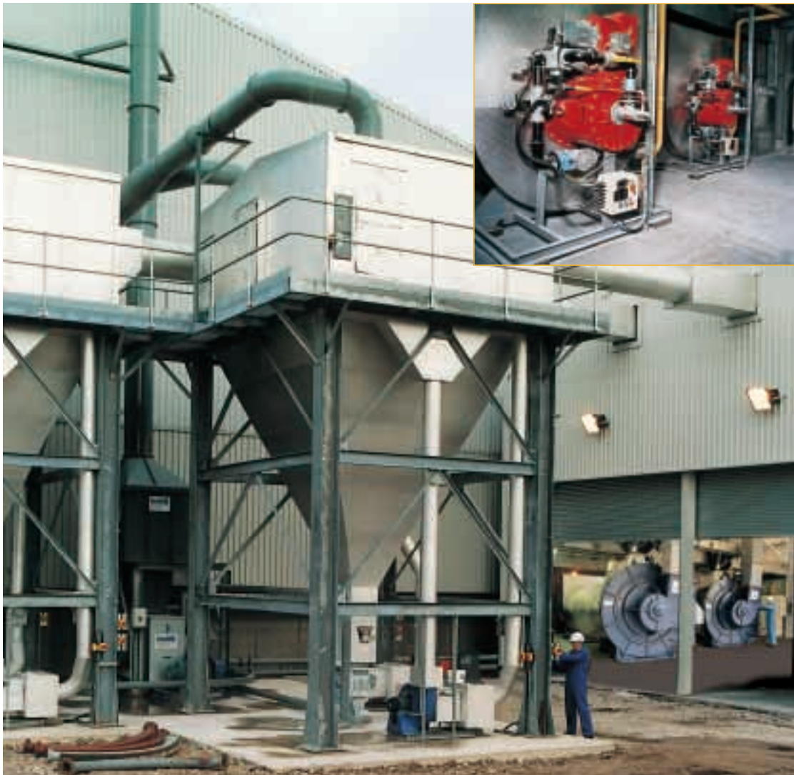
18A-Trocknungs- und Dispergieranlage für Fluorapat in 2 Linien
