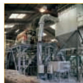
Installation de séchage de phosphate
