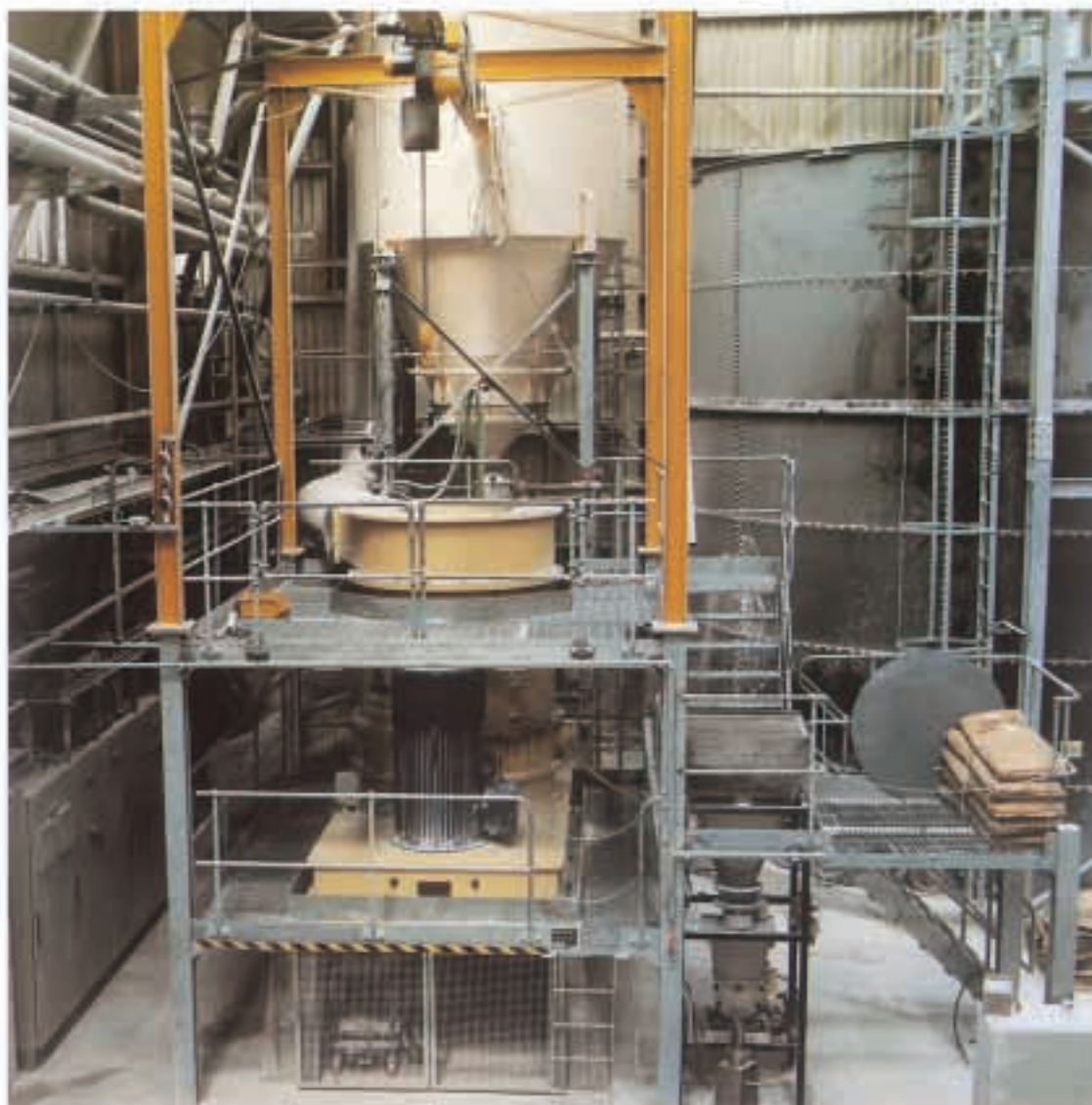
Installation CM 1500 de séchage et de revêtement pour carbonate de calcium
